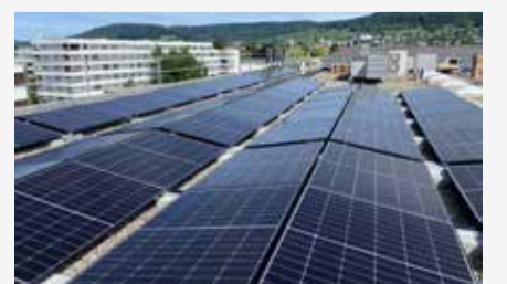
PVA-Anlage an der Rütistrasse.
